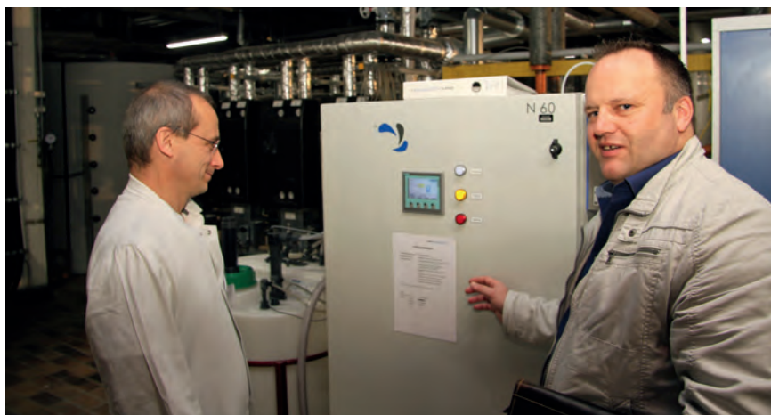
Dr. med. Bernhard Heising (li.), Leiter des Zentrums für Infektiologie und Krankenhaushygiene im Krankenhaus Düren, und Dirk Baudisch (re.), Technischer Leiter bei Marx Wassertechnik, freuen sich über die Vorteile der neuen Lösung zur Trinkwasserdesinfektion. Bild: Stephan Johnen
