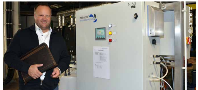
Dirk Baudisch, Technischer Leiter bei der MarxGruppe, inspiziert die Anlage, die im Keller des Krankenhauses das Desinfektionsmittel produziert und in die Wasserleitungen steuert.
